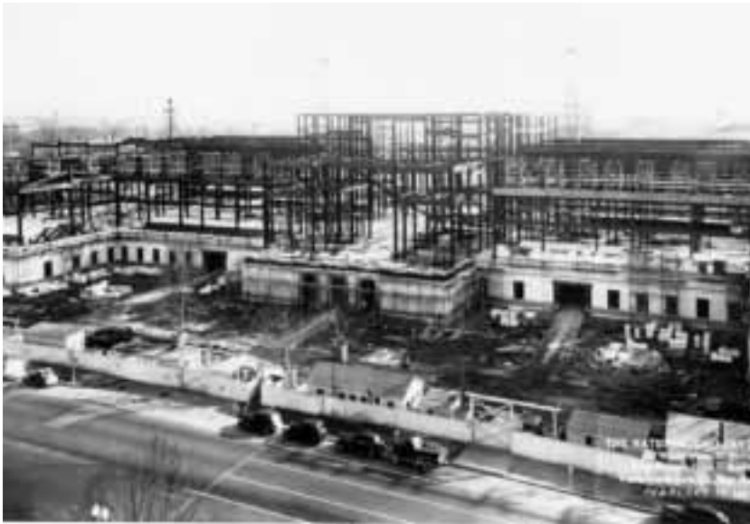
Photographie de chantier. La structure en acier de la National Gallery of Art, 1939. National Gallery of Art, Washington.
